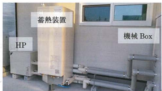
図2 蓄熱装置設置写真
